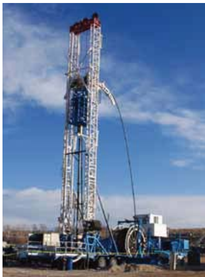
图：一套便携式石油钻井装置包括一台 20 kW 光纤激光器和低损耗光缆。波长 1070 nm 的高功率激光束射到井下碎裂、软化岩石，使得机械钻头能以较低功率去除岩石。该过程将钻井所需要的能量潜在削减了近 90%。
